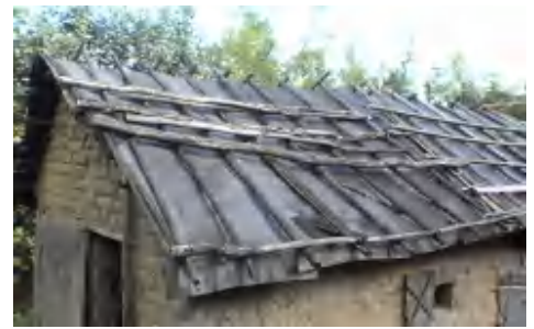
老朽化した屋根。雨漏りがひどい。
